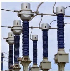
Transformadores de Medida. Alta Tensión
