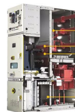
Protección de Alimentadores
